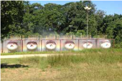
Simulación de incendio en área de tanques de propano de la Planta Carrasco.
