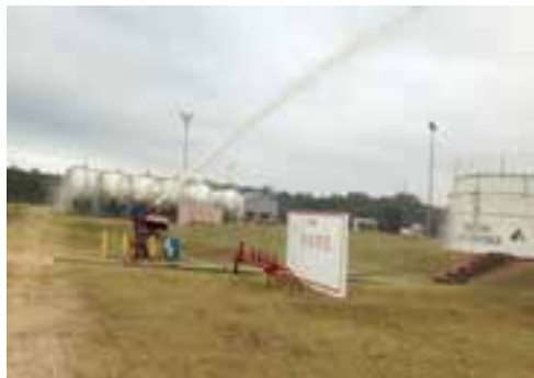
Respuesta a incendio con hidrante y enfriamiento Tk's propano (VGR)
