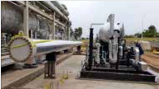
Nuevo Separador Frío en Planta Percheles
