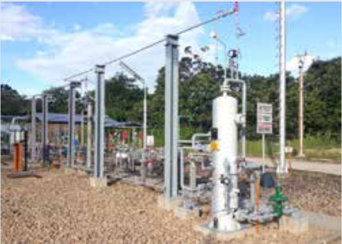
Ampliación Sistema de Gas Combustible en Batería Bulo Bulo
