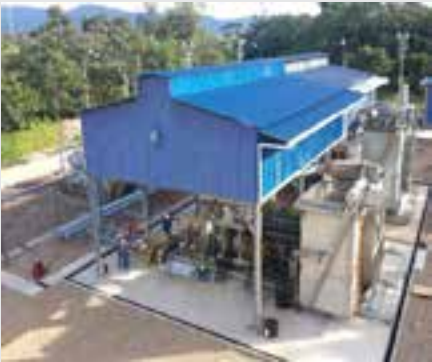
Nuevo Compresor y Galpón en Batería Bulo Bulo
