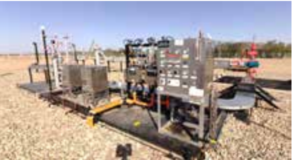
Skid de Control del pozo COL-4H
