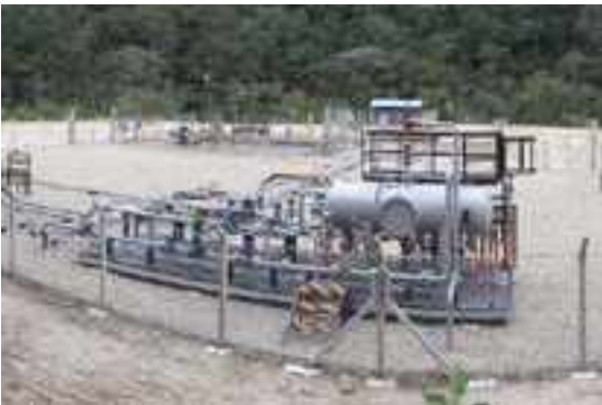
Facilidades de Producción Instaladas
