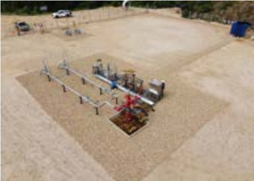
Vista Aérea Facilidades Pozo SRS-12D
