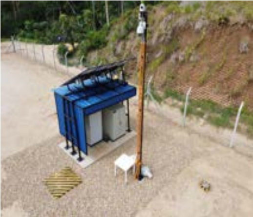
Caseta de gabinetes SRS-12D
