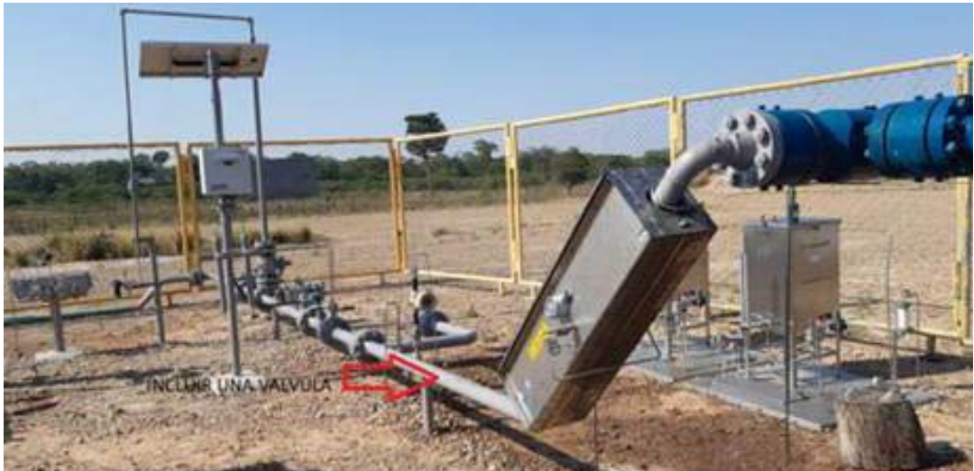
Instalaciones Provisionales Pozo FLA-X2
