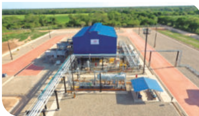
Vista de áreas de separación, gas de servicio y bombeo
