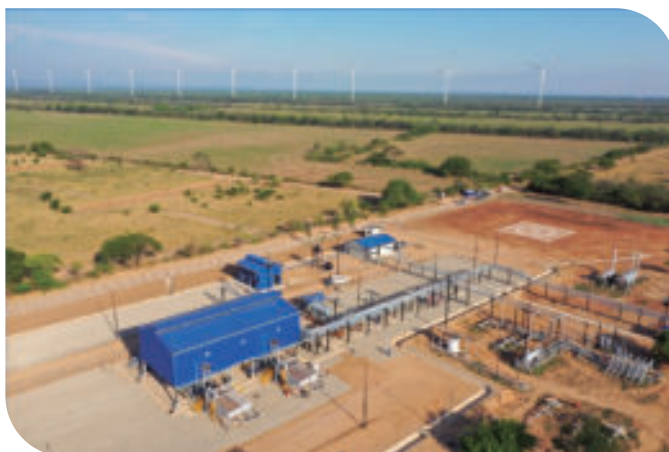
Vista de Bateria de Compresión y Paraque Eólico El Dorado.
