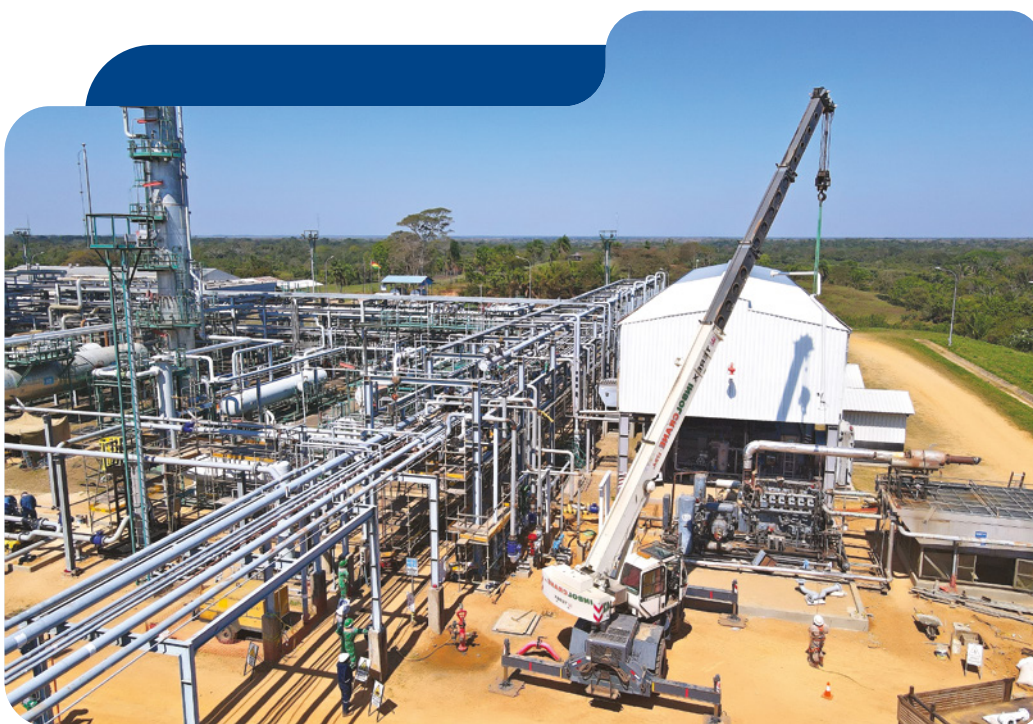
Sistema de compresión Sub Baja en Planta Santa Rosa
