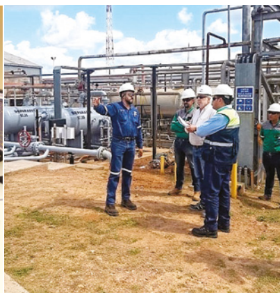
Auditoría Proyecto Instalación de Línea VGR-X1001
