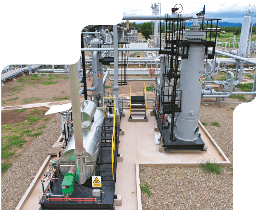
Unidad de remoción de mercurio
