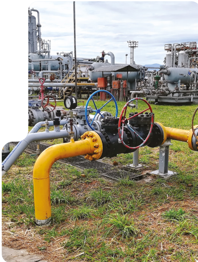
Mejoras en interconexiones del sistema de compresión
