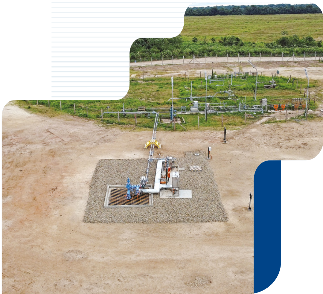
Instalaciones de superficie PNW-6D
