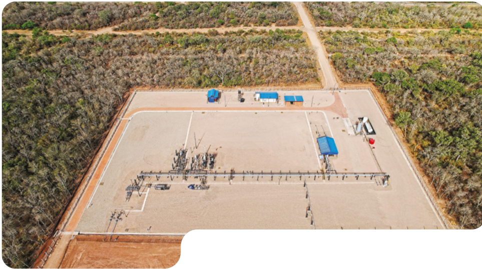
Instalaciones batería de Producción LMS - AGC
